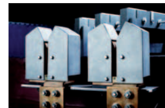
Stromkupplung eines vertikalen Vakuumofens
